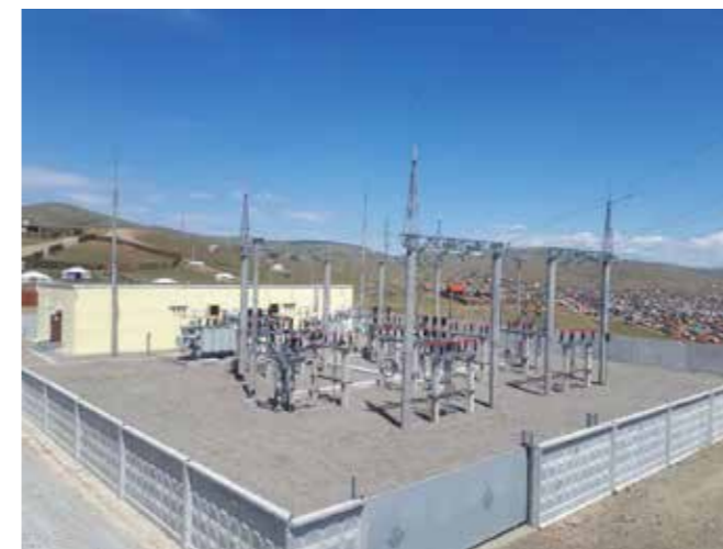
35/10 кВ-ын 2х10 МВА чадал бүхий Хөгжил дэд станц
